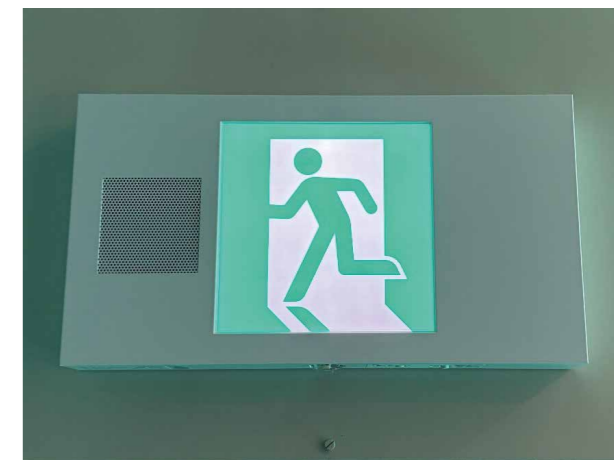
避難口誘導灯
